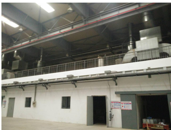
试车废气处理设施
