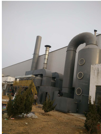
喷漆废气处理设施
