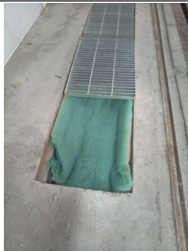
喷漆房地面的玻璃纤维棉
