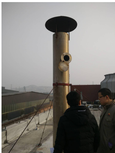
锅炉废气排气筒
